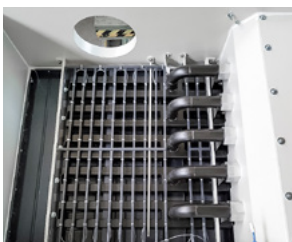
Wärmedetektion zur Branderkennung
